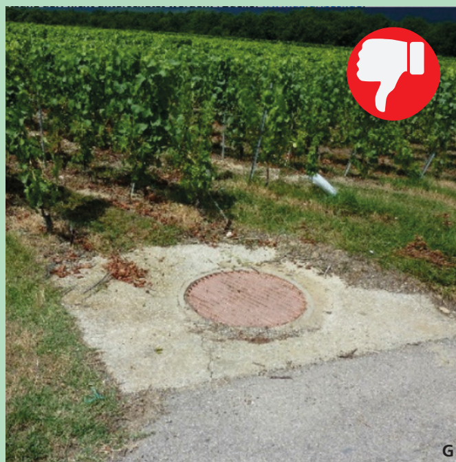
Das Risiko indirekter Einträge über die Kanalisation oder Meteorleitungen muss berücksichtigt werden!
